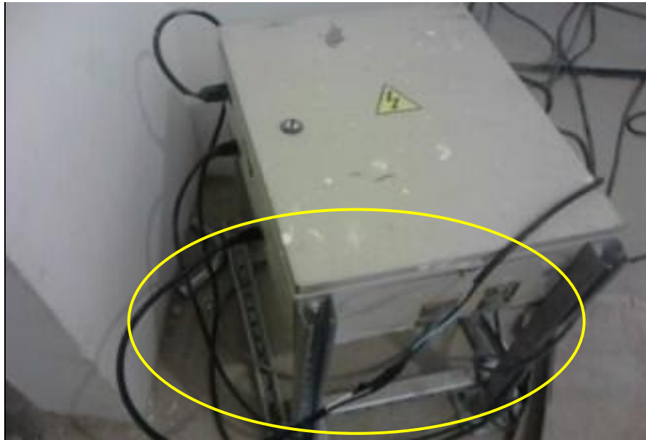
Figura 18 – Quadro elétrico com cabo elétrico sobre o mesmo.
