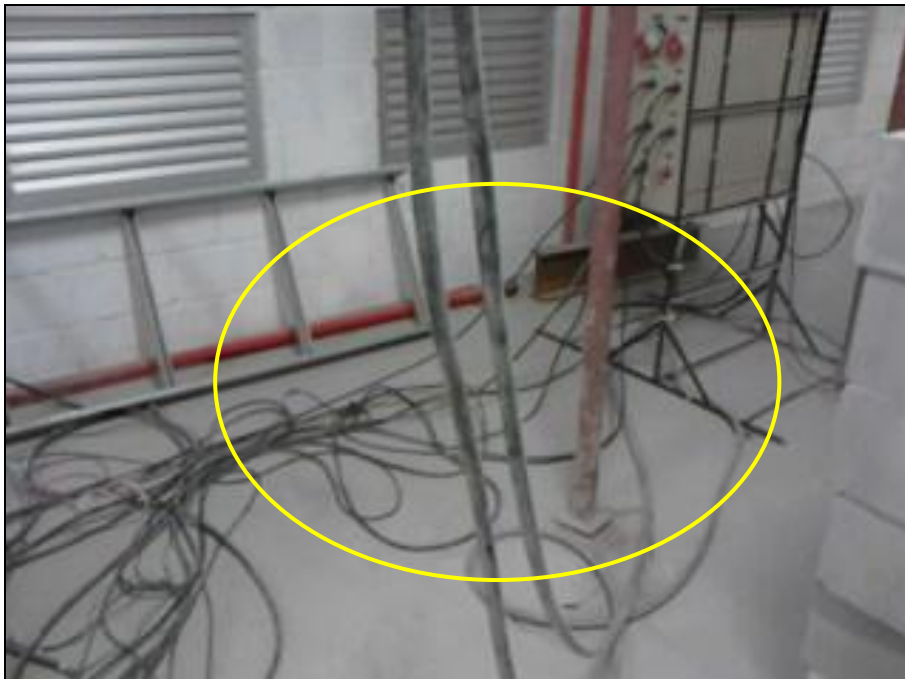
Figura 19 – Cabos elétricos expostos.
