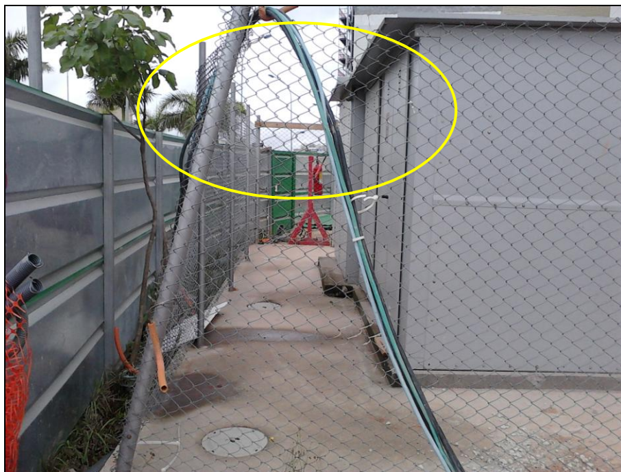
Figura 20 – Cabos elétricos soltos sobre uma grade de proteção.
