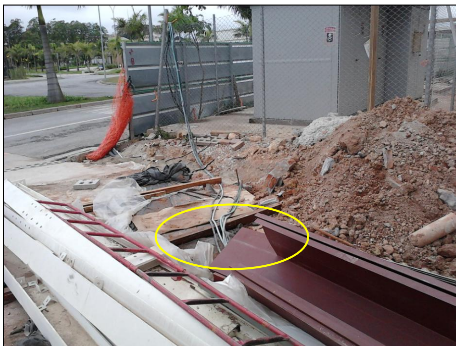
Figura 21 – Cabos elétricos no piso sobre madeiras e abaixo de chapas metálicas.
