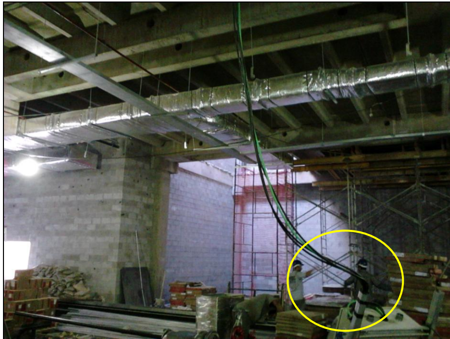
Figura 23 – Cabos elétricos expostos no canteiro de obra sem proteção.
